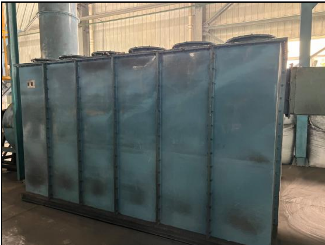
图 4-3 废气治理设施照片（活性炭吸附装置）
