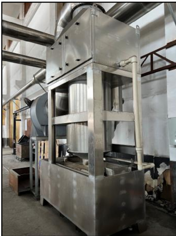
图 4-2 废气治理设施照片（气旋式水喷淋装置）
