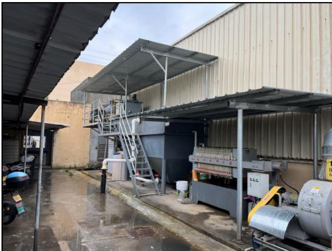
图 4-2 废水处理设施照片
