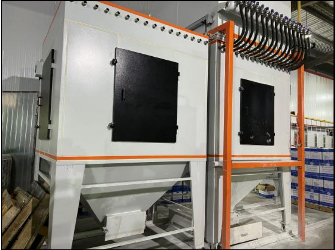
图 4-4 喷塑废气治理设施照片
