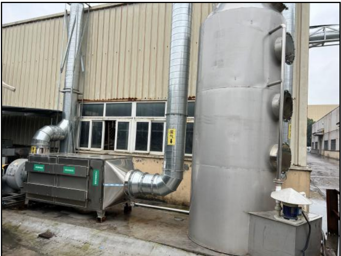
图 4-5 喷塑固化废气治理设施照片
