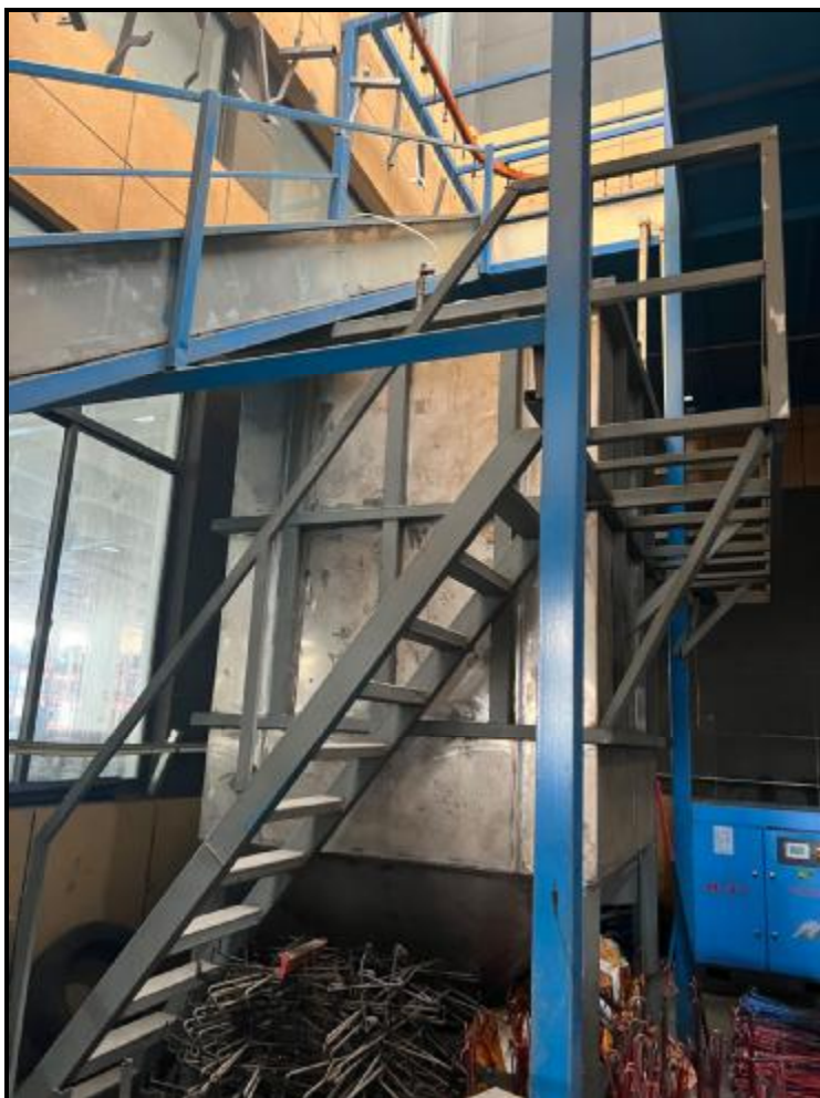
图 4-2 废水处理设施照片
