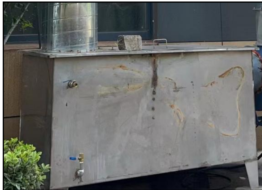
图 4-5 切割废气治理设施照片
