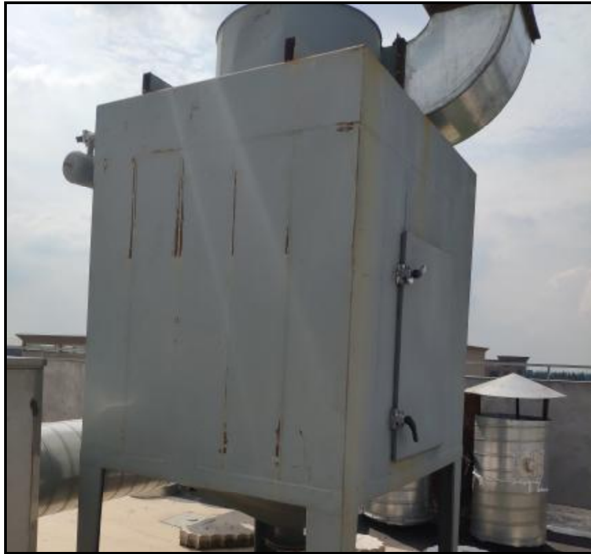
图 4-4 焊接废气治理设施照片
