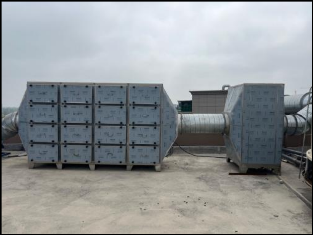
图 4-2 废气治理设施照片
