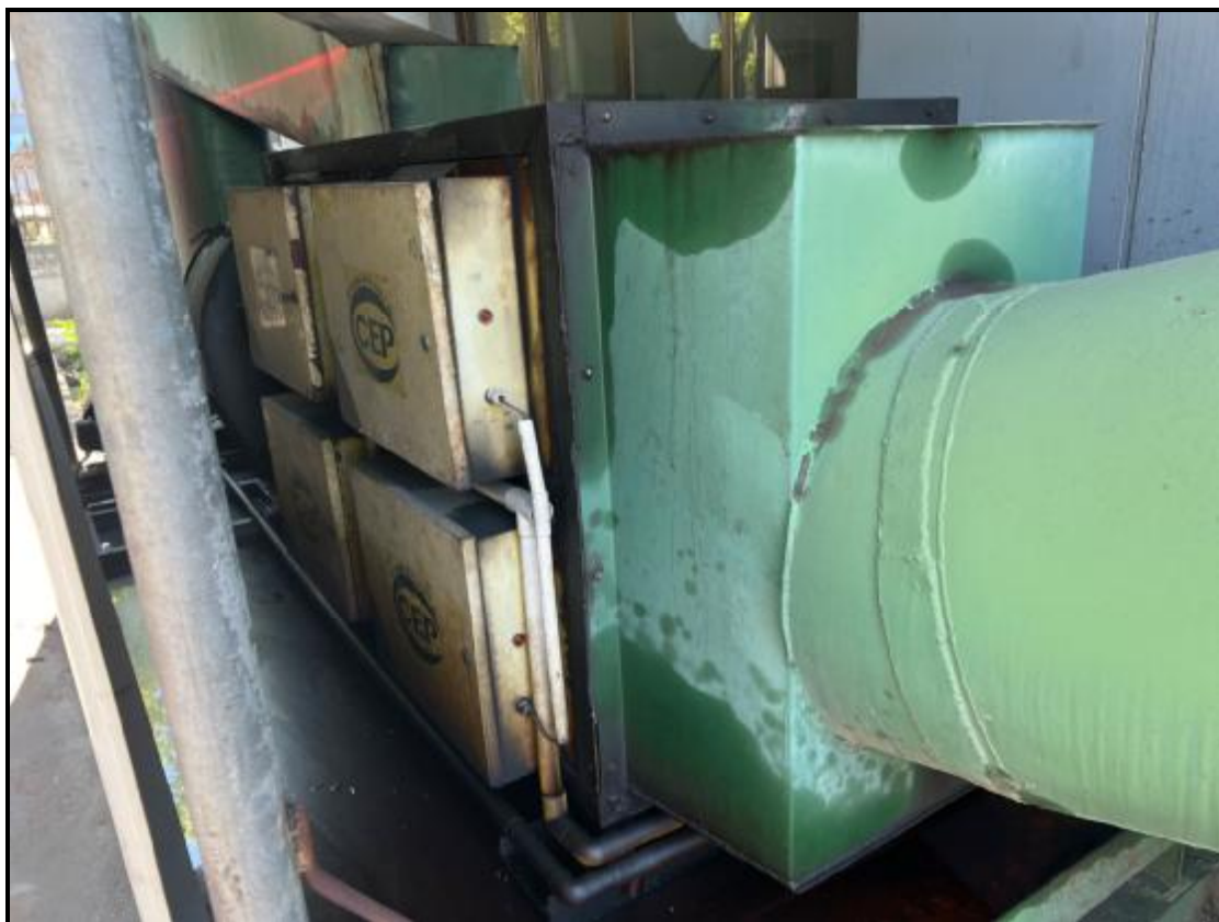
图 4-2 废气治理设施照片
