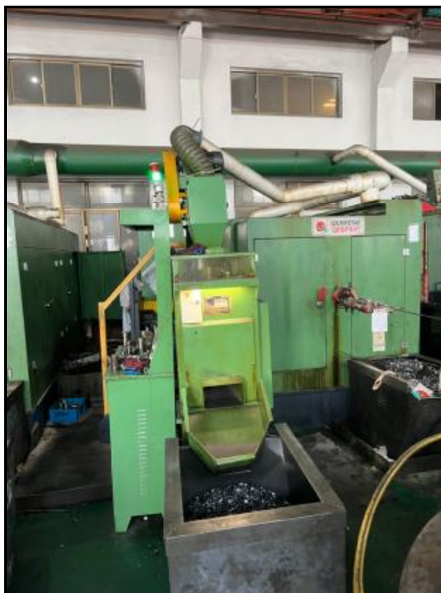
图 4-3 废气收集设施照片
