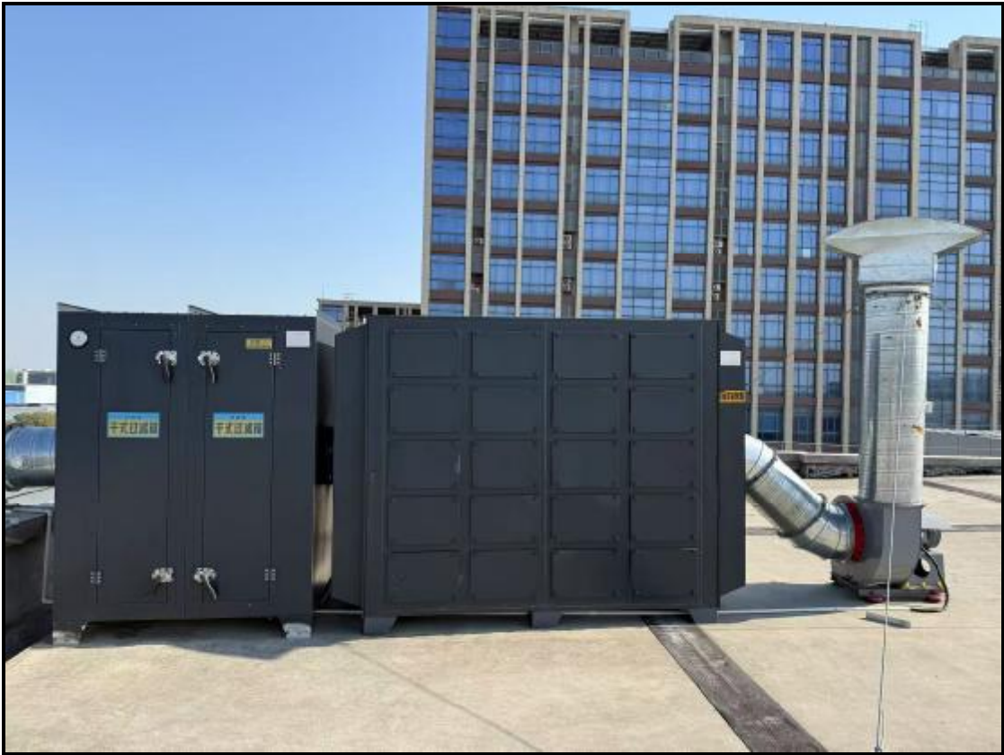
图 4-2 废气治理设施照片
