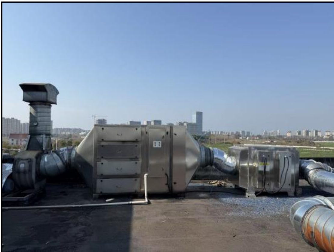
图 4-3 废气治理设施照片（挤出、切粒风冷废气）
