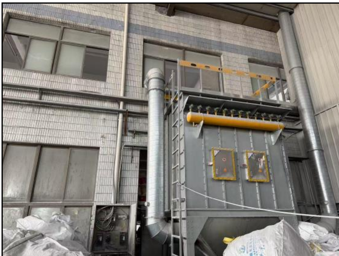
图 4-2 废气治理设施照片（投料、破碎粉尘）
