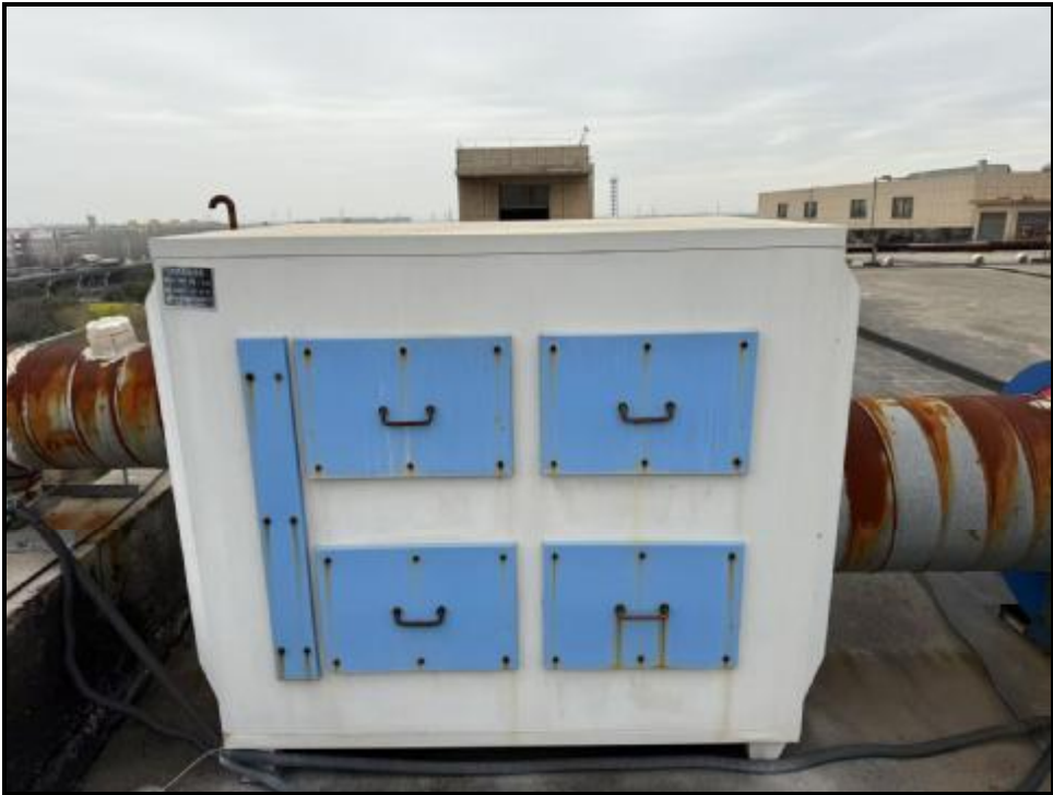
图 4-2 废气治理设施照片
