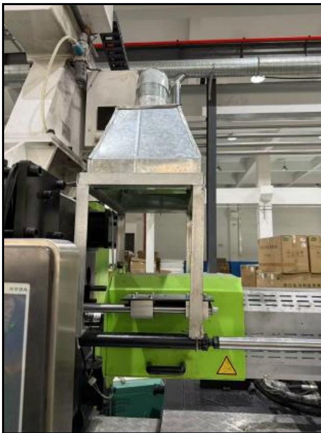
图 4-3 废气收集设施照片
