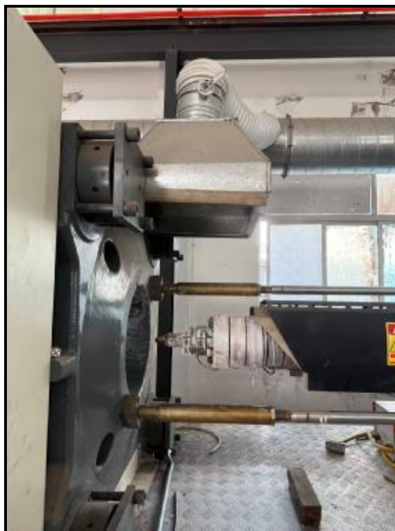
图 4-3 废气收集设施照片
