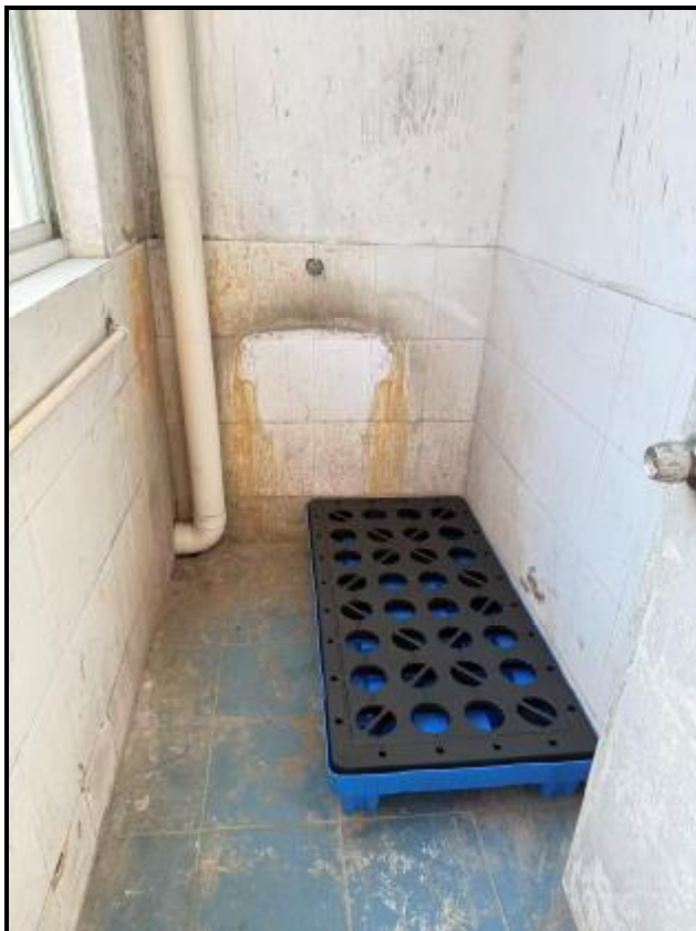
图 4-5 危废暂存场所照片（内部）
