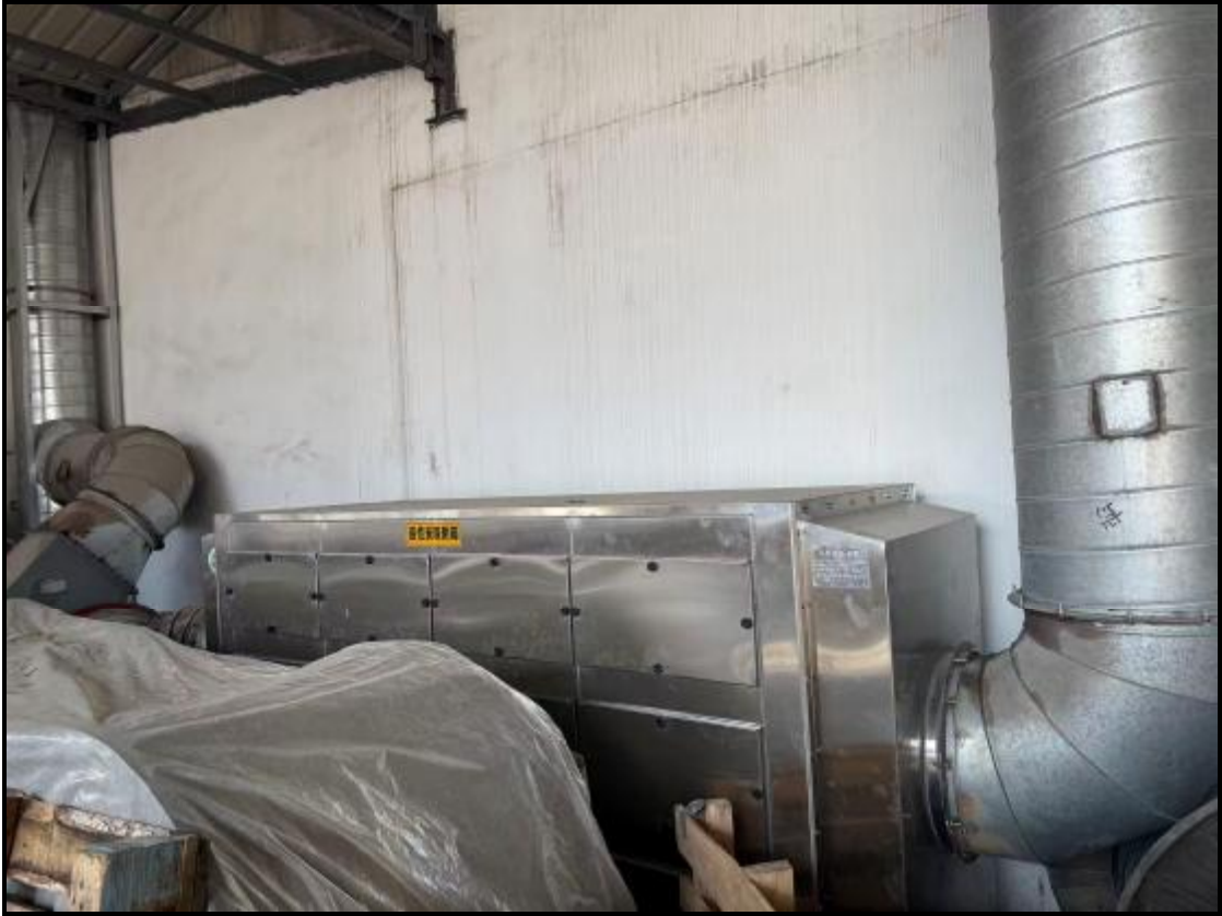
图 4-2 废气治理设施照片
