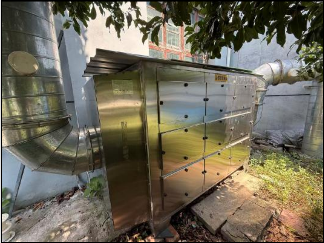
图 4-2 废气治理设施照片
