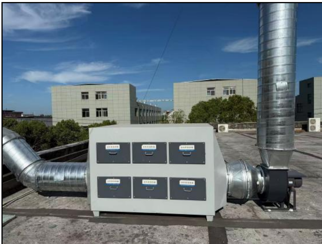
图 4-3 废气治理设施照片（复合废气）
